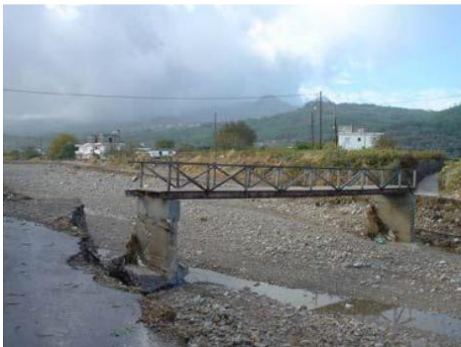
Σχ. 1.9 Φθορές στην πεζογέφυρα ύστερα από την πλημμύρα του 2001 (Πηγή: Διεύθυνση Γεωργίας Νομαρχιακής Αυτοδιοίκησης Σάμου)
